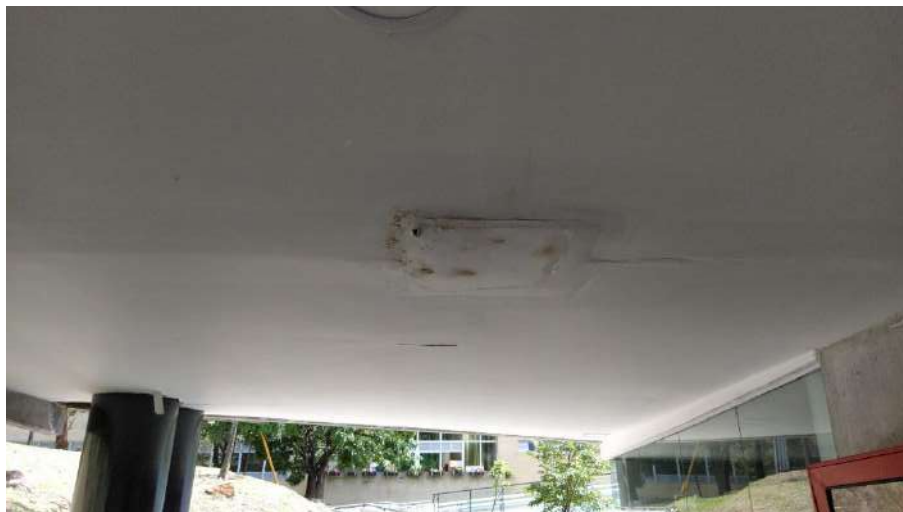
Imágenes ilustrativas del estado de la edificación
