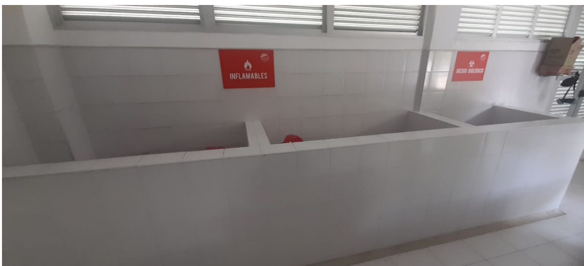
Imagen Almacenamiento residuos peligrosos
